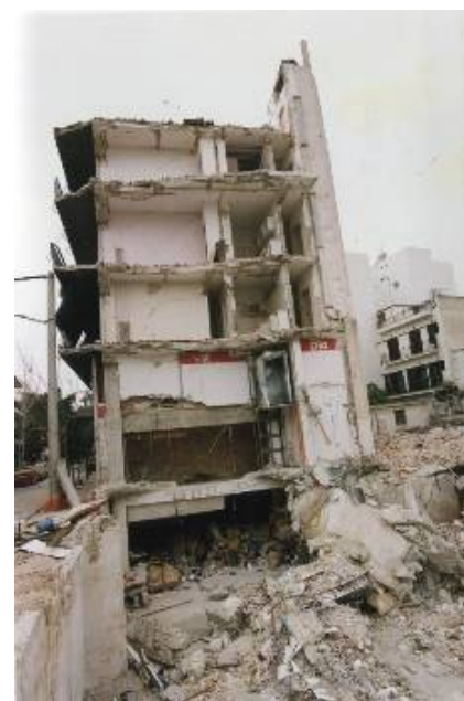
Η πολυκατοικία στη Ν. Φιλαδέλφεια που κατέρρευσε σαν «χάρτινος πύργος»
